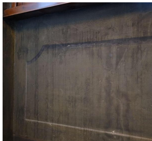
Colature da infiltrazione
