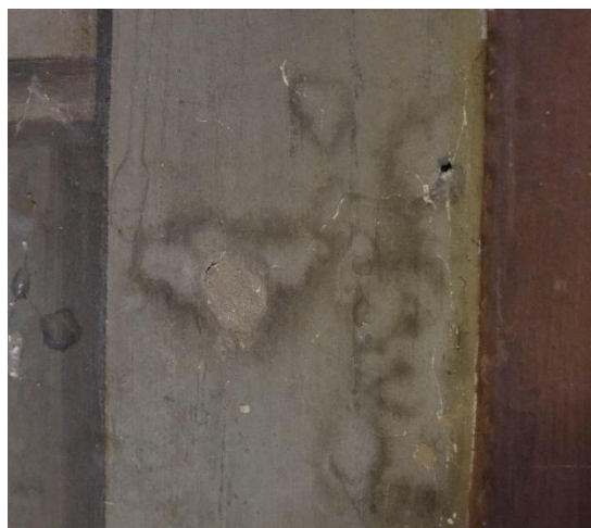
Macchie dovute alla presenza di acqua
