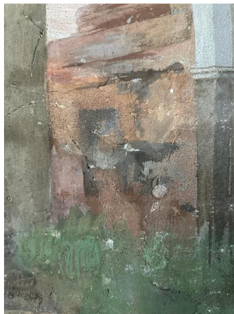
Abrasioni ed efflorescenze saline
